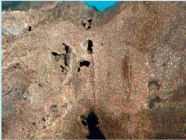
Fig. 15 - Saldatura difettosa che necessita di un rifacimento.
